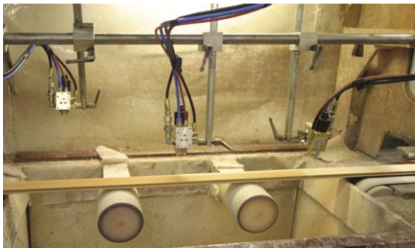
4 - Le pistole misto-aria installate in una delle verniciatrici.
